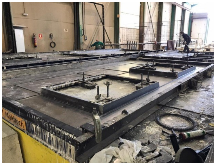
Figura 5. Colocación de anclajes durante la fabricación de la placa prefabricada. Fuente: Los autores
