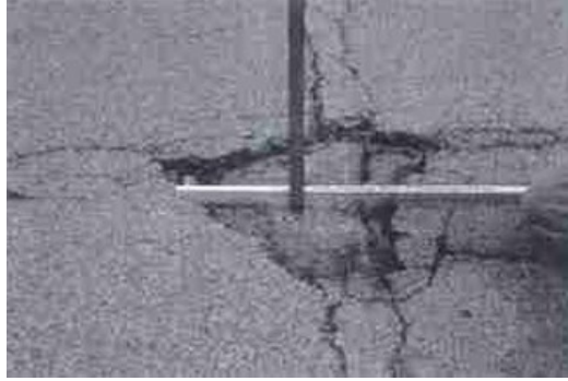
Figura 10. Deterioro bacheo de severidad media.
