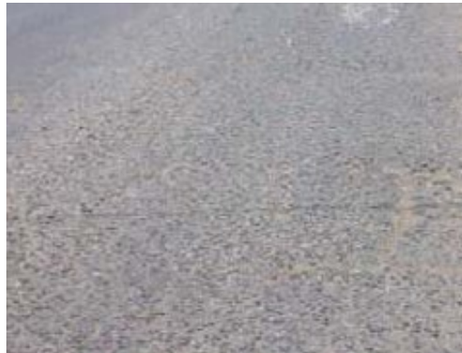
Figura 12. Deterioro peladura de baja severidad.
