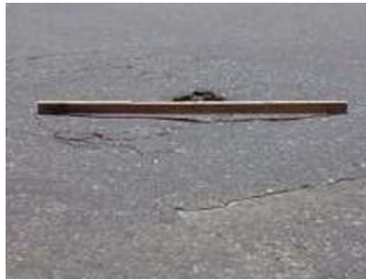
Figura 15. Deterioro depresión de alta severidad.
