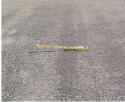
Figura 14. Deterioro exudación de severidad media.
