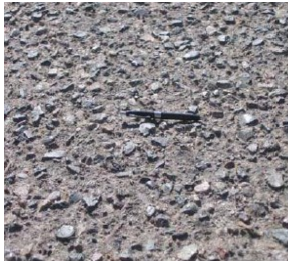
Figura 8. Deterioro desgaste por envejecimiento de alta severidad.
