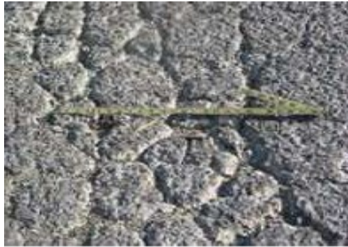
Figura 11. Deterioro piel de cocodrilo de alta severidad.
